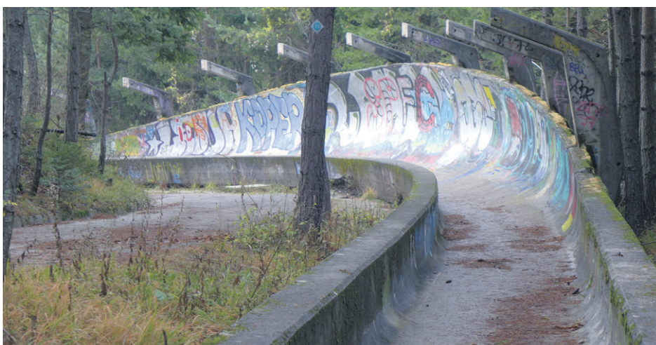
Jernbeton forgår ikke så let. Men bobslødebanen har formentlig ikke været benyttet til andet end graffiti siden OL 1984. Synet af den ramponerede bane mellem træerne er ret surrealistisk.
